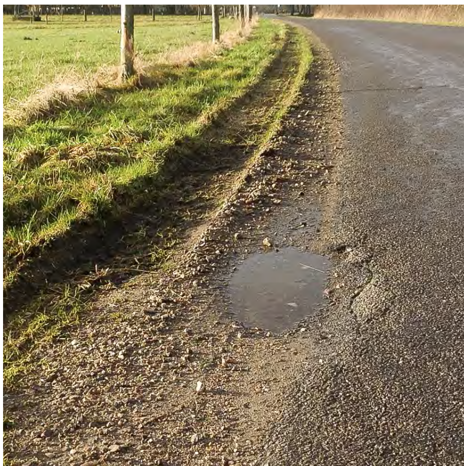
Figur 2. Rabatskader og krakeleringer i belægning kan være selvforstærkende for vejens nedbrydning.
