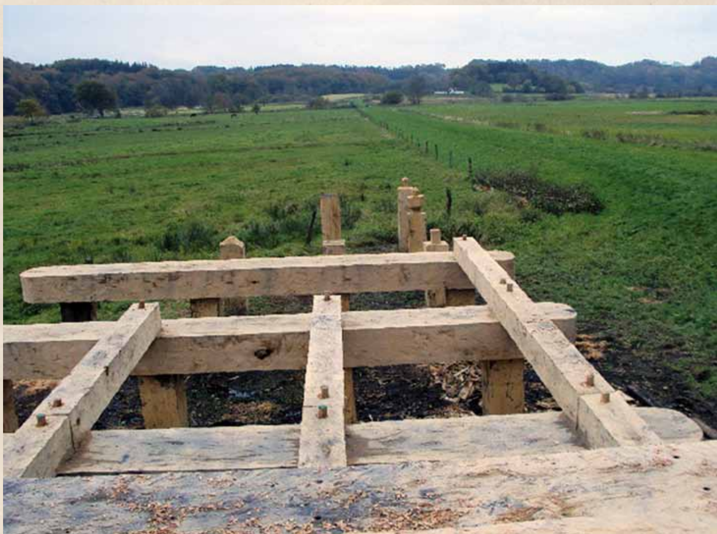
Figur 1. I efteråret 2011 opførte Vejle Museum i samarbejde med Kulturarvsstyrelsen og Naturstyrelsen en ny rekonstruktion af broen. Den 760 m lange og 5 m brede bro har gået i lige linje over ådalen.
