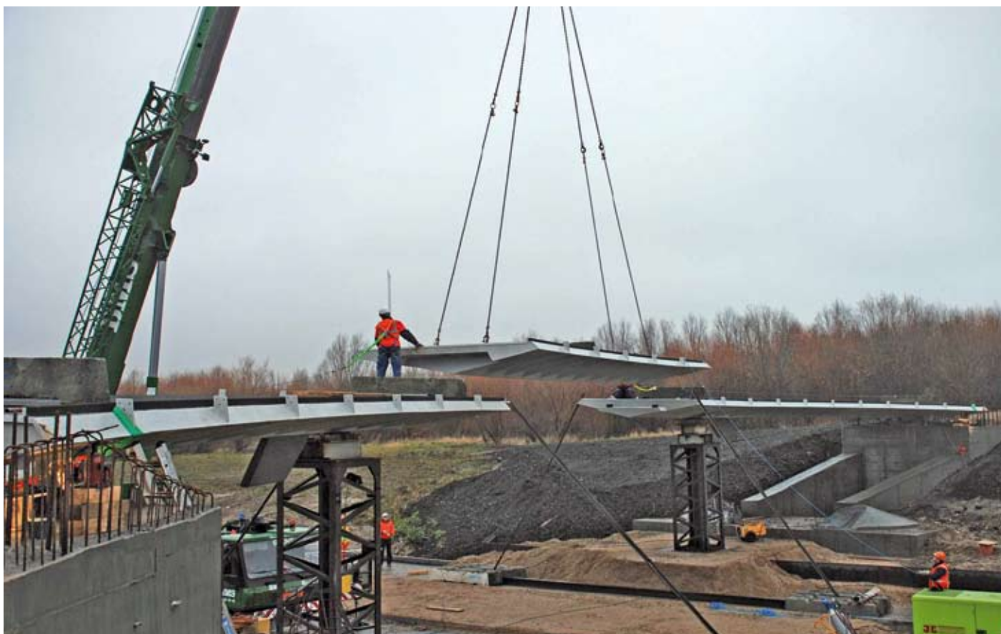
Figur 2. Det 12 meter lange midterfag løftes på plads under anlægsarbejdet. En mobilkran som denne vil også komme på arbejde en gang i mellem i fremtiden, når særligt høje transporter skal passere. (Foto: Grontmij | Carl Bro).
