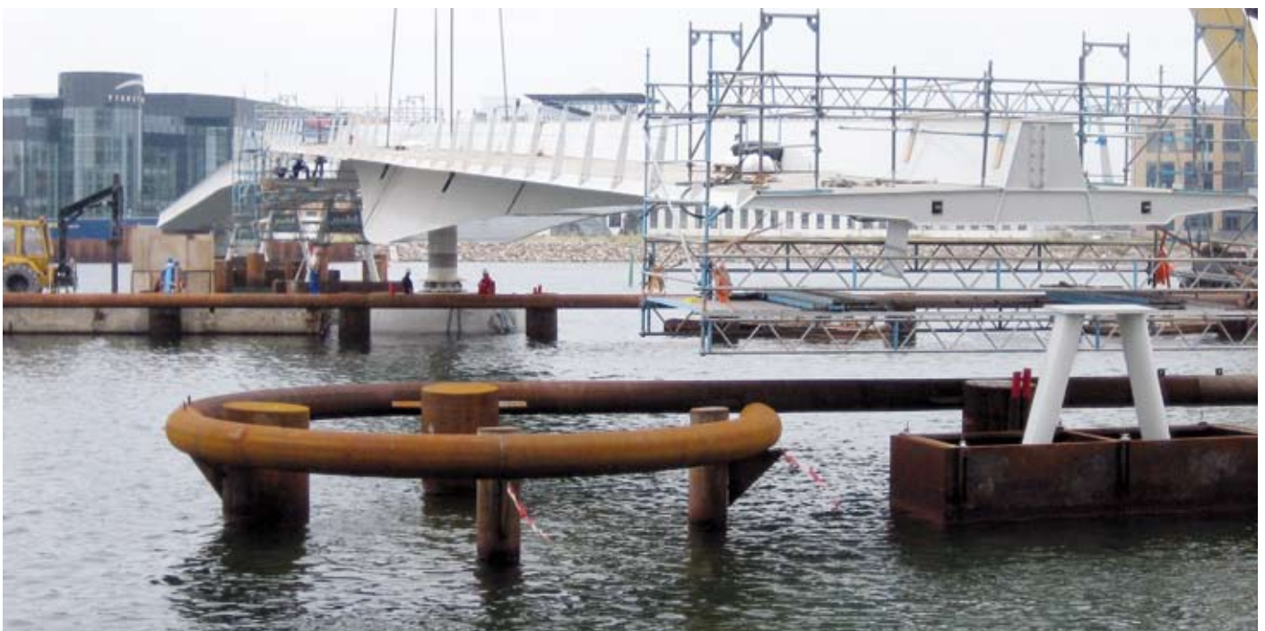
Svingfaget løftes på plads. Vægt af svingbro 250 tons. Foto Finn Berthelsen, Grontmij | Carl Bro A/S.
