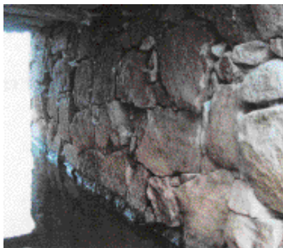
Figur 5. Landfæste efter restaurering. Bemærk de åbne fuger.
