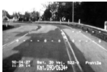
Billede optaget af videobilen med 0,5 m markeringer over vejtværslit.
